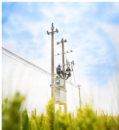
供电服务人员帮助种业小镇用户排查用电设备隐患,并向种植户宣讲电力安全知识。赵娣 摄
