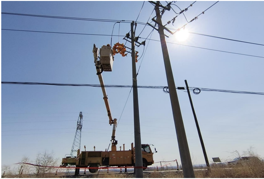
图为国网奎屯供电公司采用带电作业,消除10千伏开远线158号杆危机缺陷,更换受损隔离开关。 周亚珍 摄
