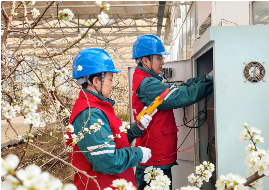
国网海西供电公司职工在仁达合作社检查用电设备。
