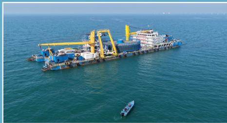
海缆敷设施工期间，海洋环境监测团队随海缆敷设船行驶海域测量并记录种群。(陈默摄)
