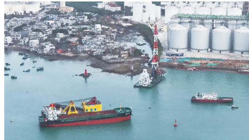
这是国投洋浦港10万吨级公共粮油码头施工现场。(受访者供图)
