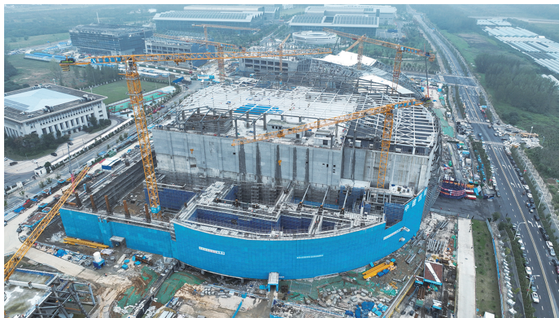
2025年10月1日拍摄的紧凑型聚变能实验装置(BEST)建设现场(无人机照片)。
