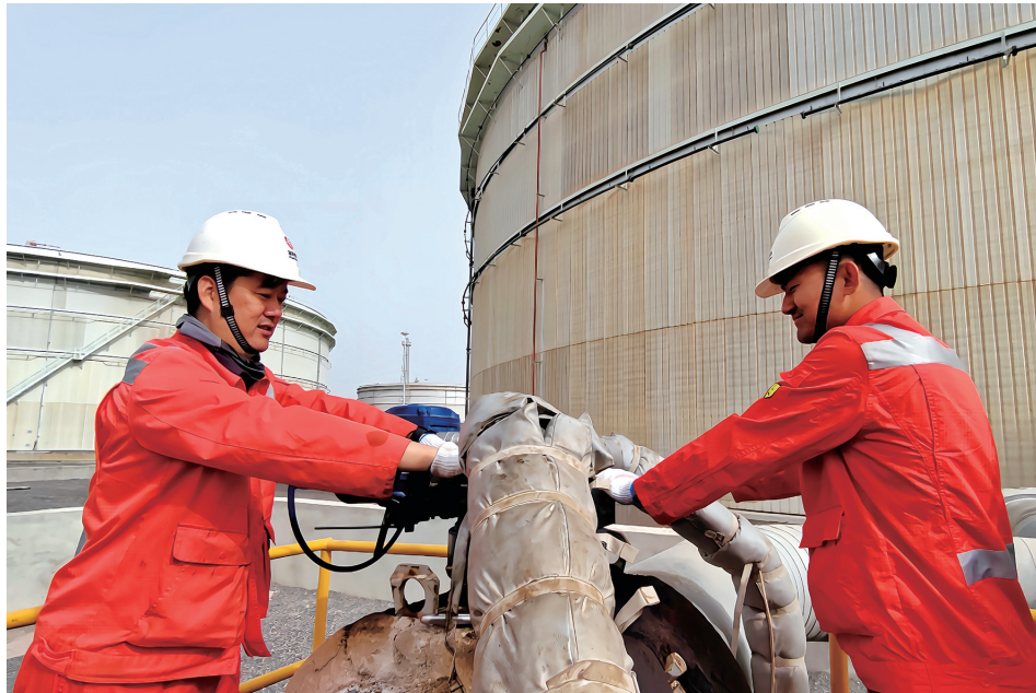
2025年10月,国家管网集团西部管道公司员工正在对油库阀门进行维护保养。
