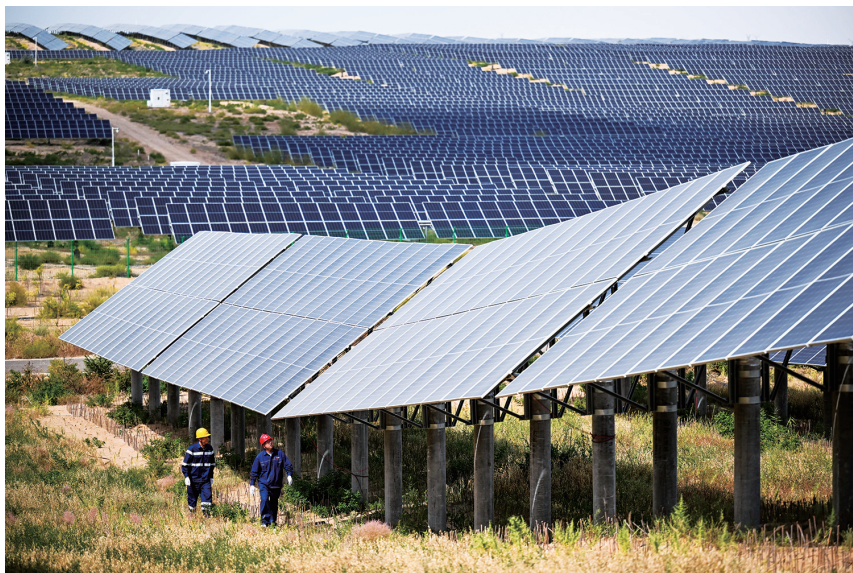
9月10日,工人在位于库布其沙漠的达拉特旗光伏基地巡检。
