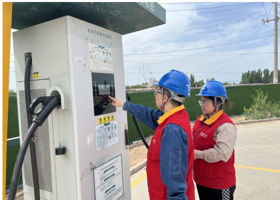
国网吐鲁番供电公司共产党员服务队对吐鲁番干热自然环境试验基地附近的充电桩进行“全方面”体检。(受访单位供图)
