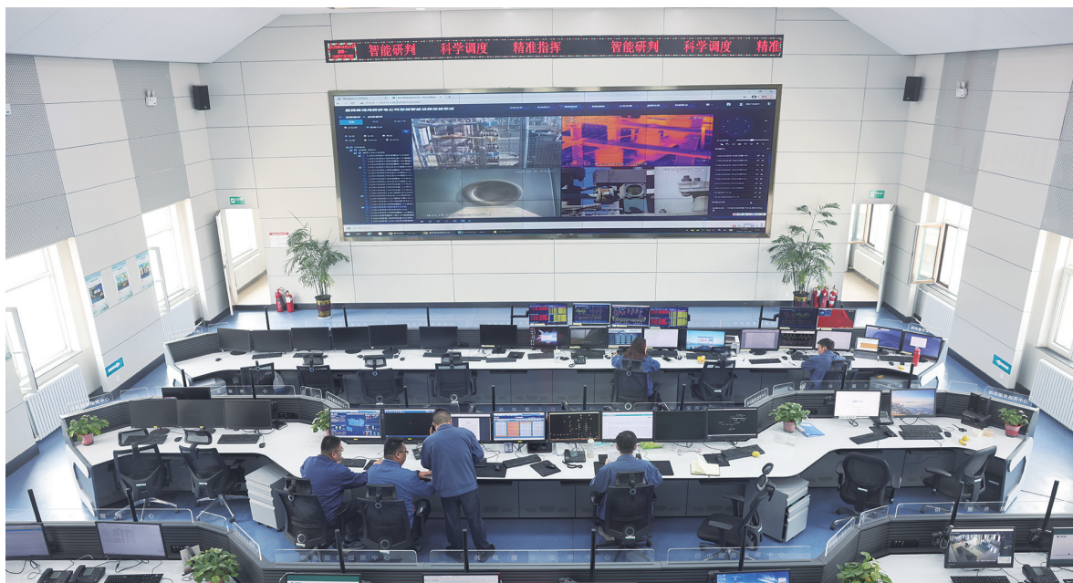
国网青海省电力公司海西供电公司变电集控中心。
