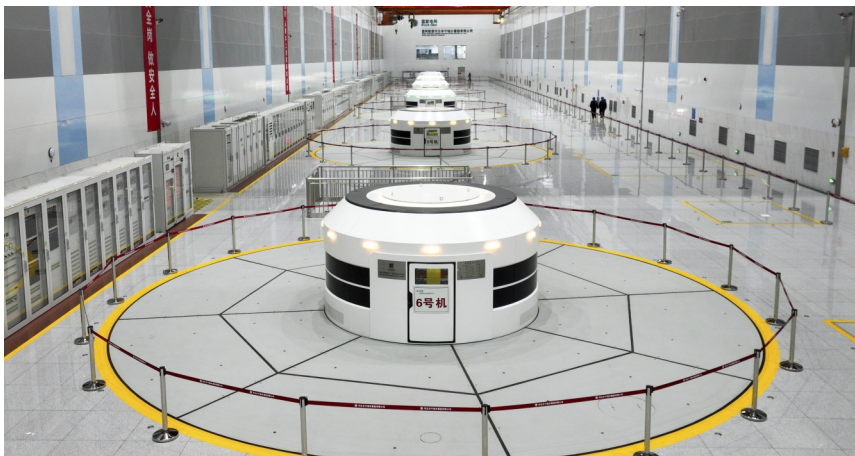
这是2024年12月31日拍摄的国家电网河北丰宁抽水蓄能电站地下厂房（无人机照片）。 新华社发（王立群 摄）
