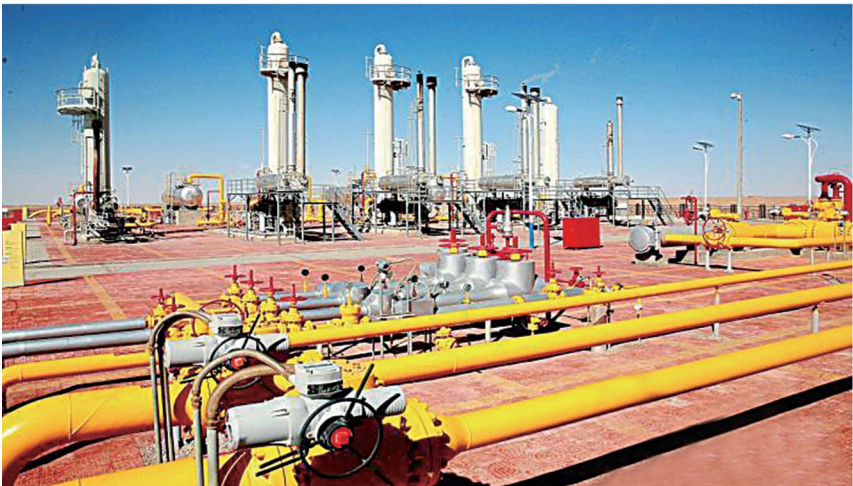
图为涩北气田集气站。
