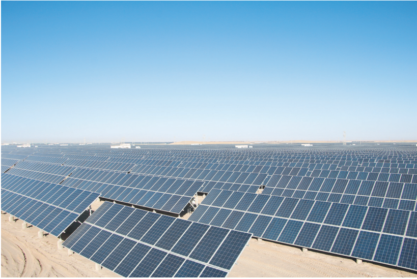
国电格尔木光伏发电有限公司项目基地一角。
