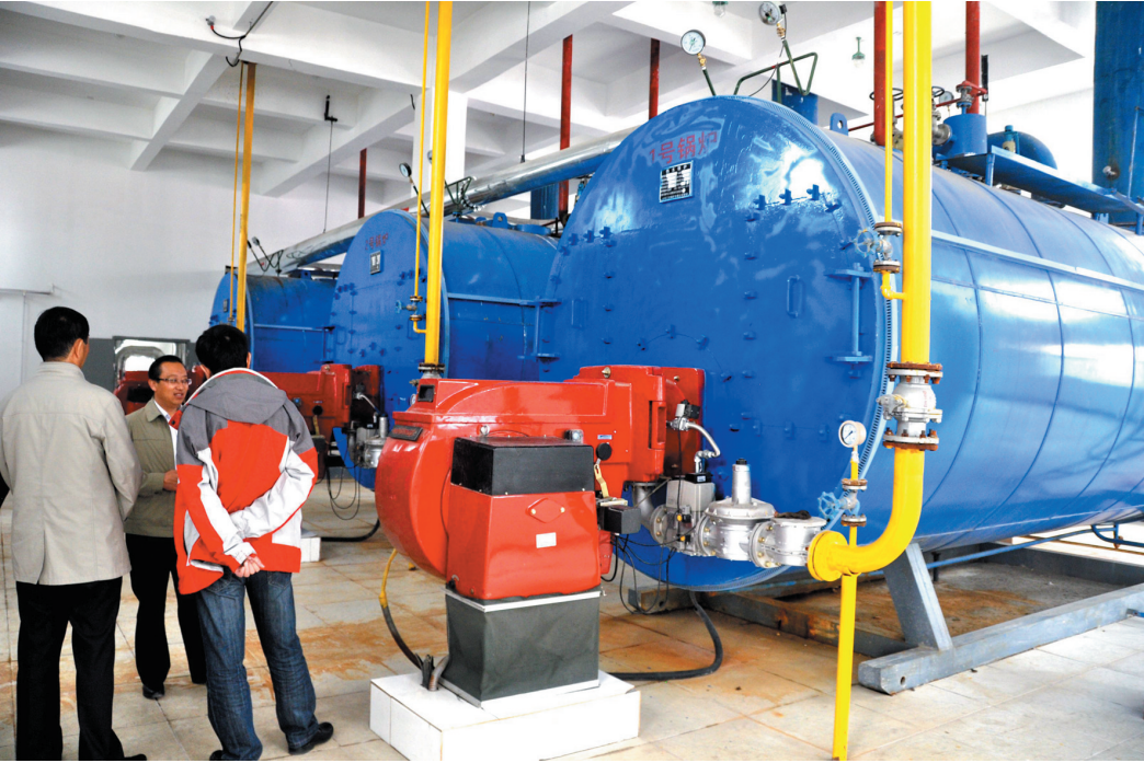
今年，我市加大资金投入，实施锅炉“煤改气”工程，截至目前，全市共完成“煤改气”锅炉332台（911吨）。图为体育场公租房片区在建的“煤改气”锅炉，今年冬天将为该片区居民集中供暖。 记者 武强 摄
